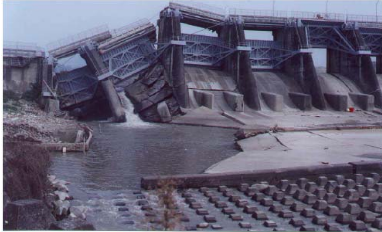
شکل ۷- آسیب سرریز Shih-Kang تحت زلزله Chi-Chi در سال ۱۹۹۹
