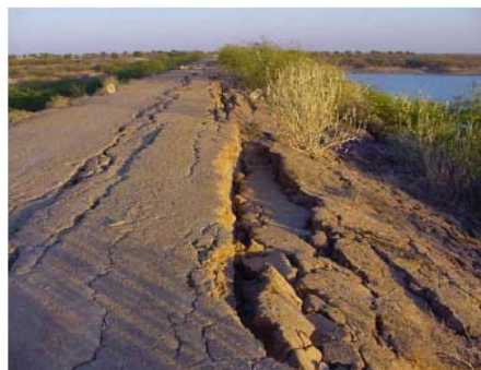
شکل ۱- شکست سد خاکی تحت زلزله Bhuj در سال ۲۰۰۱
