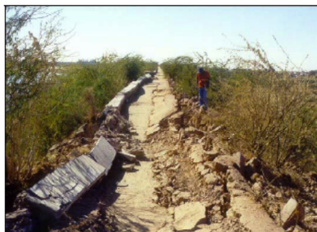
شکل ۲- آسیب در تاج سد خاکی تحت زلزله Bhuj در سال ۲۰۰۱
