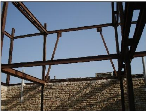
استفاده نامناسب از بادبندهای بیرون محور
