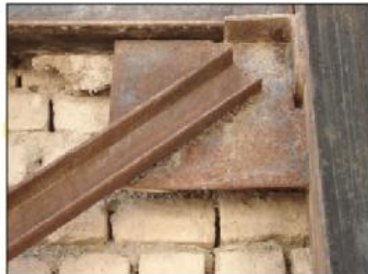
عدم جوش ورق اتصال بادبند به پل تیر از قسمت زیر، بعد جوش کم اتصال بادبند به ورق، عدم جوش زنجیره ای وجود نوچه در جوش
