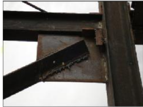
عدم جوش ورق پایدندی به پال تسیر از قسمت زیر کیفیت پایین جوش اتصال پایدندی به ورق پایدندی، عدم استفاده از ضد زنگ
