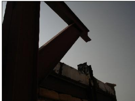
عدم استفاده از ورق برای اتصال دستک به ستون
