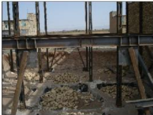
عدم اجرای کامل ضدزنگ بر روی اسکلت نشزی
