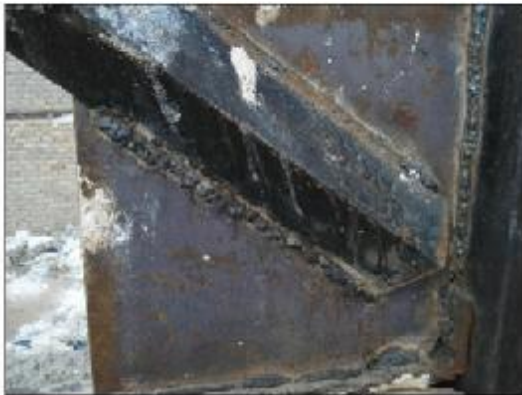
زنجیره ای نبودن جوش و وجود لوله در آن
