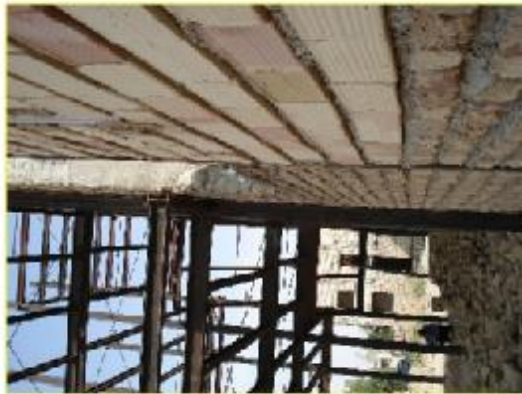
عدم اجرای فرز انقطاع در هرز ساختمان با ساختمان مجاور
