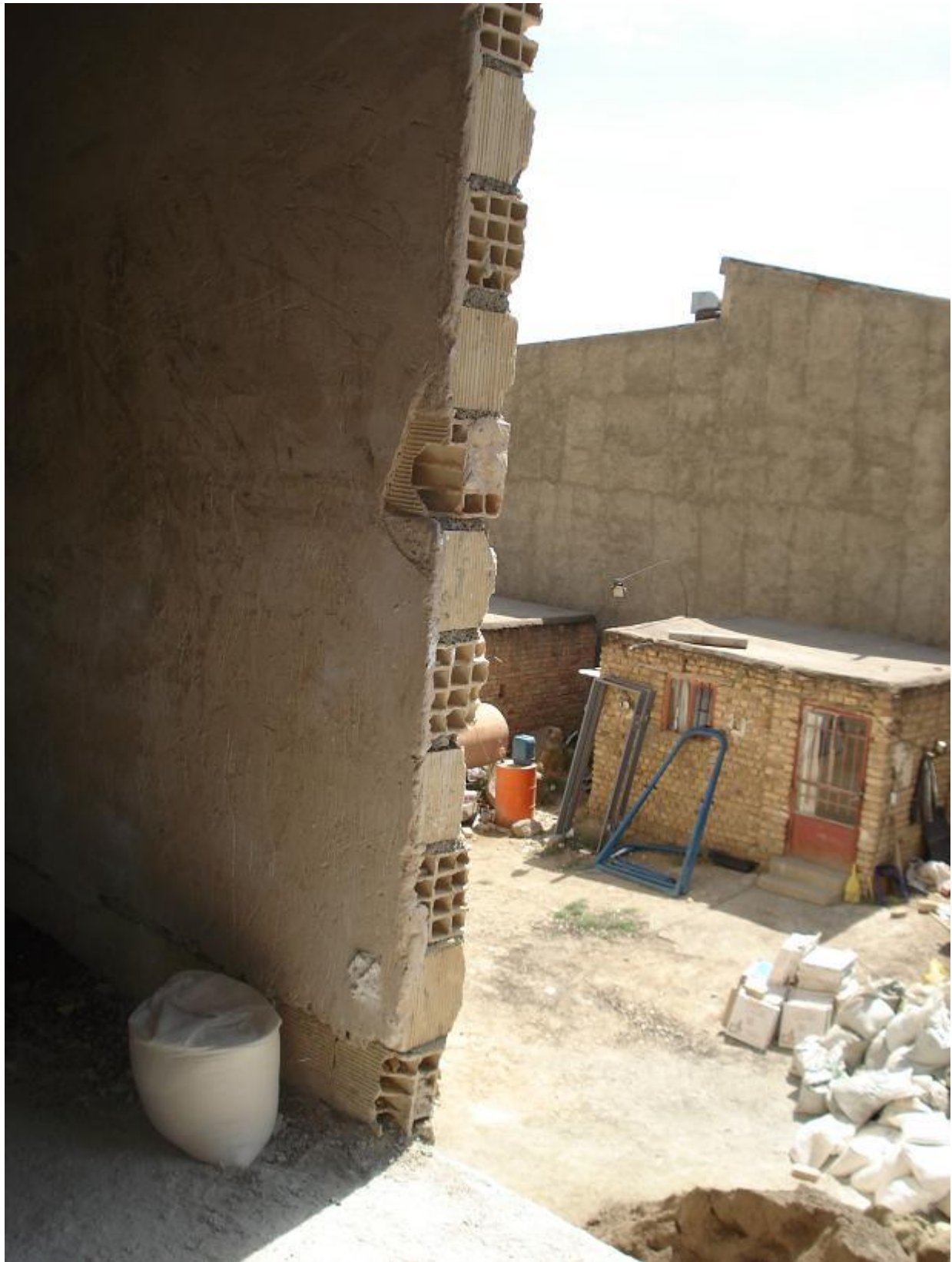
لطفاً به انتهای تیغه نشان داده شده در شکل توجه کنید. انتهای تیغه با کلاف (بتنی، فولادی یا حتی چوبی) مهار نشده است . مطابق بند 3-12-2 آیین نامه 2800 برای کلیه ساختمانها رعایت بندهای 7-3 و 12-3 همین آیین نامه برای تیغه ها الزامی است
