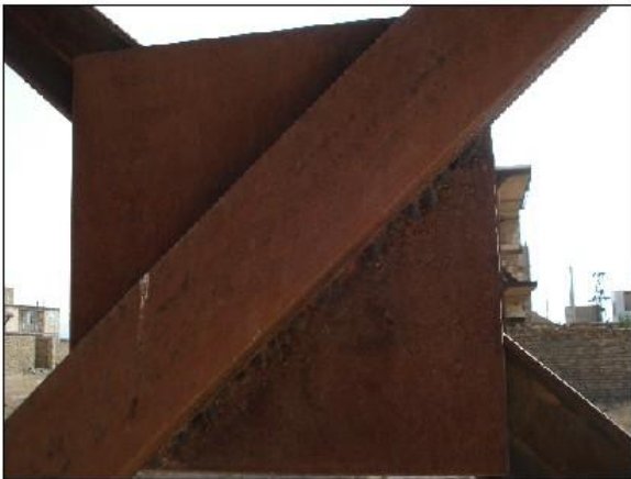
استفاده از مقطع تک برای بادبند، کیفیت پایین، جوش عدم استفاده از ضدزنگ
