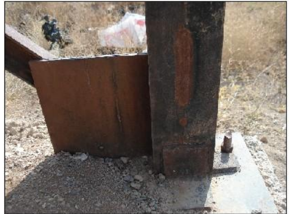
کوچک بودن ورق اتصال بادبند به صفحه ستون و عدم استفاده از جوش پیوسته در مجاورت اتصال ورق بادبندی به ستون
