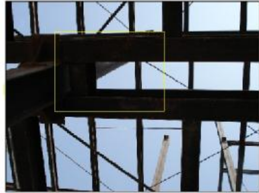
عدم استفاده از ورق بست بزرگ برای اتصال تیر دویل خورجینی در مجاورت اتصال تیر به ستون
