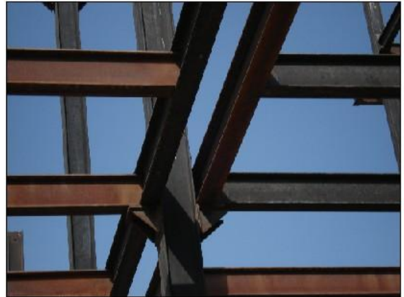
عدم استفاده از ورق بست بزرگ برای اتصال دو تیر خورجینی در مجاورت اتصال تیر به ستون
