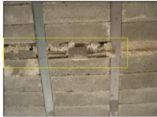
اجرای نامناسب کلاف میلانی سقف تیرچه بلوک
