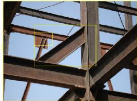
اتصال مستقیم در دئ ستون، عدم اجرای ورق اتصال برای دستگاه، اتصال خارج از محور بادبند نسبت به مرکز ورق اتصال
