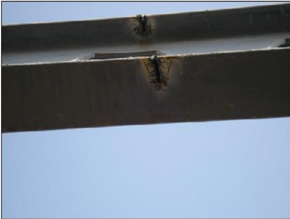
سوختگی بال تیر در اثر جوشکاری نامناسب
