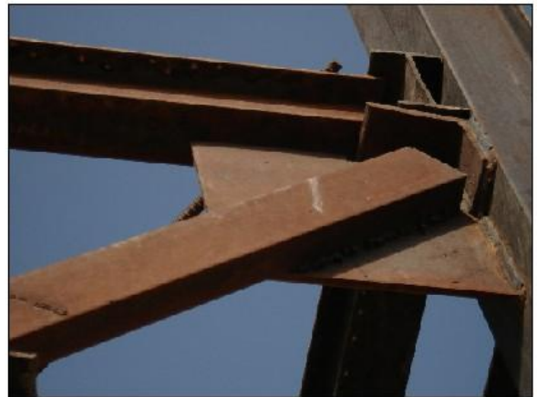
کیفیت پایین جوش، عدم جوش ورق بادبندی به بال تیر از قسمت زیر
