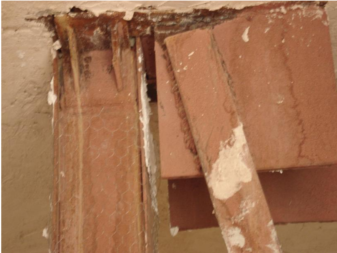
عکس فوق اتصال یک دستک (برای نگهداری تیر طره) به ستون را نمایش میدهد. همانطور که مشخص است ورق اتصال به ستون جوش نشده است و تنها به تیر طره جوش شده است.
