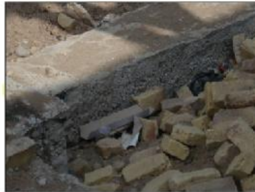
گرم بودن بتن پی
