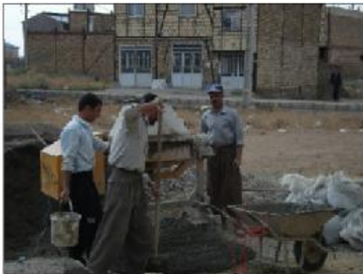
عدم استفاده از لباس کار مناسب برای کارگران
