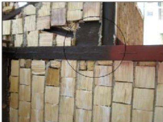
عدم اجرای جوش پیوسته در ساخت سنگین در محل اتصال تیر و پادبند به سنگین
