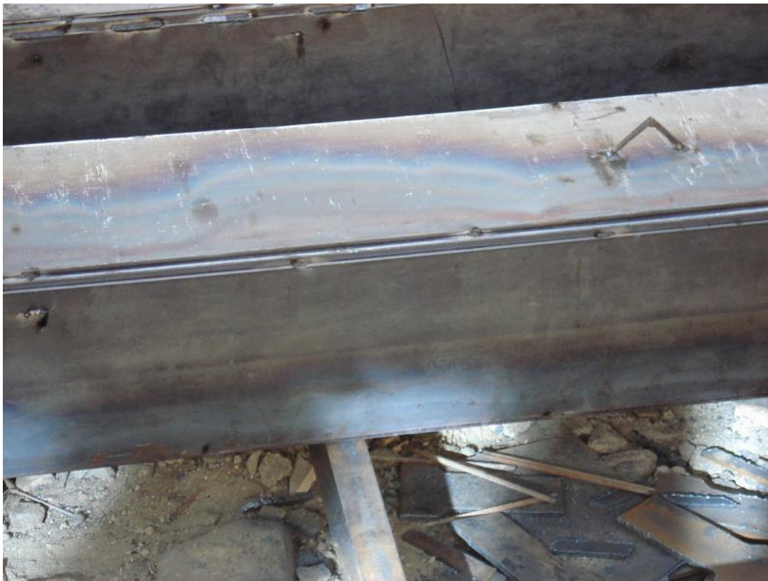
گداختگی ورقهای ستون در اثر گرمای جوش عکس بالا یک ستون تیرورقی را پس از جوشکاری نشان میدهد. همانطور که در شکل دیده میشود در اثر گرمای جوش ورقهای ستون دچار گداختگی شده اند. این مساله احتمالاً در اثر آمپر بالای دستگاه جوش و عدم مهارت جوشکار بوده است
