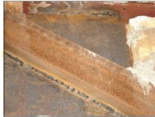
بعد جوش کم اتصال و زنجیره ای نبودن جوش و وجود لوله در جوش
