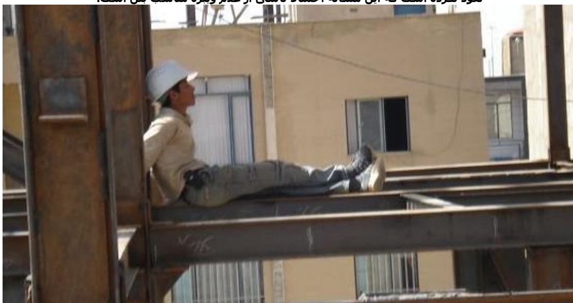
کارگر زیر 15 سال بدون وسایل ایمنی در بالای اسکلت ساختمانی
