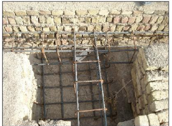
خم مناسب در انتهای میلگردهای طولی و عرضی کف پی، عدم زنگزدایی میلگردهای خاموتها
