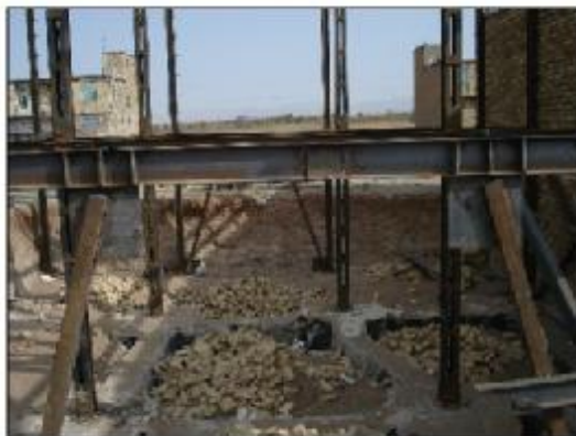
عدم اجرای کامل ضدزنگ بر روی اسکلت فلزی
