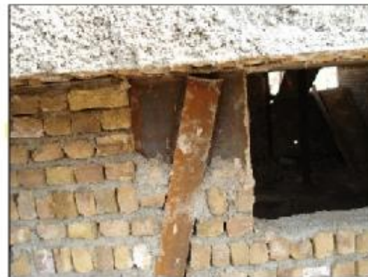
اتصال خارج از محور پادبند به ورق اتصال، عدم استفاده کامل از ضدزنگ
