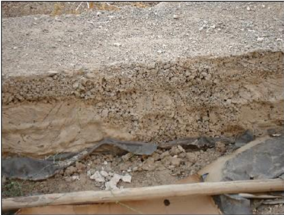
کرمو بودن بتن
