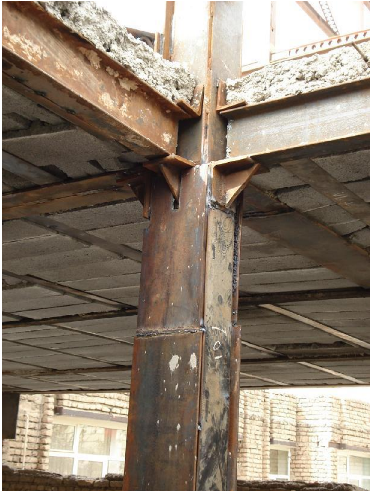
در شکل بالا اگر دقت کنید نشیمن تیر (در سمت چپ) به داخل جان ستون جوش شده است و سپس ورق تقویت بر روی ستون جوش شده و البته با توجه به تداخل با نشیمن ورق تقویت بریده شده است . غیر از آن ورق سمت چپ در ستون در مقطعی به فاصله کمتر از 90 سانتیمتر از تراز نشیمن تیر وصله شده است. (مطابق بند 5-
