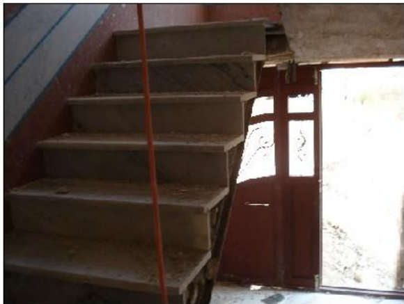
عدم اجرای نرده موقت یا دائم در لبه راه پله
