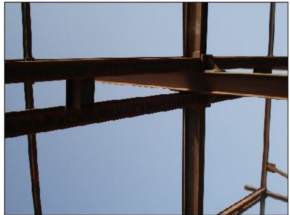
عدم اتصال تیر دابل خورجینی در مجاورت اتصال تیر به ستون با ورق بست بزرگ
