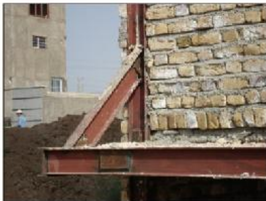
اتصال دستهک به فل مستون، عدم استفاده از ورق اتصال برای اتصال دستهک، عدم استفاده از تپشی برای اتصال تیر قرعی به پل
