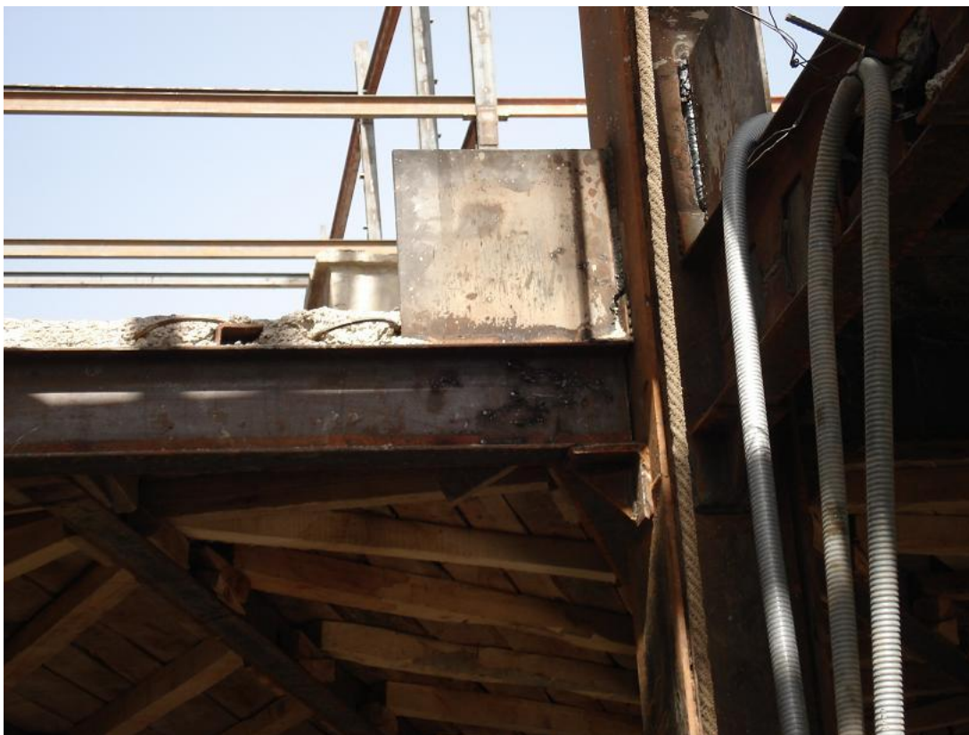
بتنریزی نامناسب در کناره های سقف کامپوزیت
