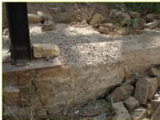
جداشدگی دانه های سطحی بتن به مرور زمان، خارج بودن بخشی از صفحه ستون از محدوده پی
