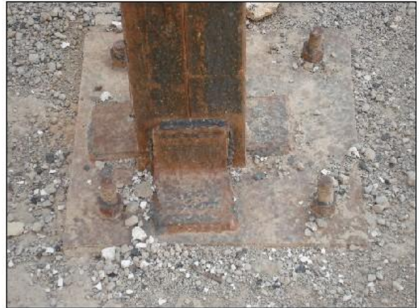
عدم اجرای ضدزنگ، خارج از محور بودن ستون نسبت به آکس صفحه ستون
