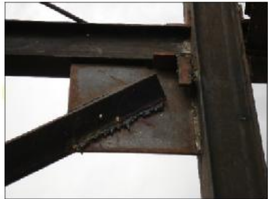
عدم جوش ورق بادبندی به پال تیر از قسمت زیر کیفیت پایین جوش اتصال بادبند به ورق بادبندی، عدم استفاده از ضد زنگ
